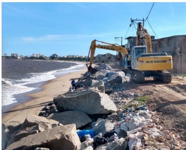
Figura 5: Erosão costeira na Barra de Macaé.
