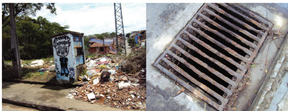
Figura 4-32: Elevatória Nova Macaé Um, desativada e abandonada e ralo que recebe efluentes.
