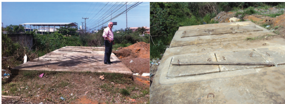
Figura 4-37: Vista da Elevatória Lagomar.
