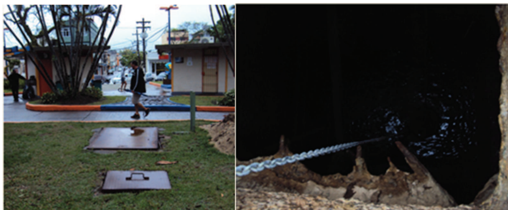
Figura 4-29: Elevatória Washington Luís.
